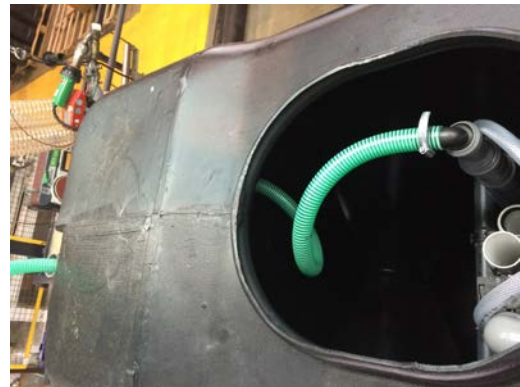
Manguera corrugada en entronque del air-lift. Sale del depósito por el lateral hacia el depósito contiguo.
