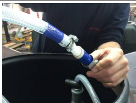
Conexión de la manguera que irá al cuadro eléctrico con la manguera del Air-Lift
