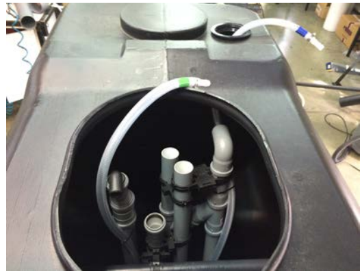
Sistema Air-lift instalado en el digester clarificador. Vista de las mangueras neumáticas.
